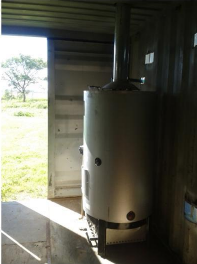
Caldera para calefacción de digester
