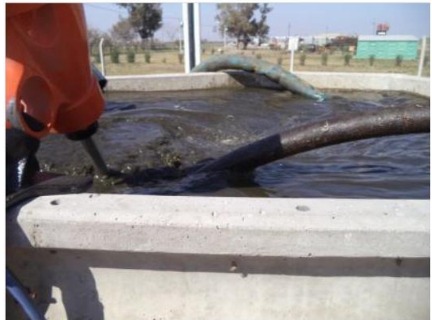
Tanque de ingreso. Agitador
