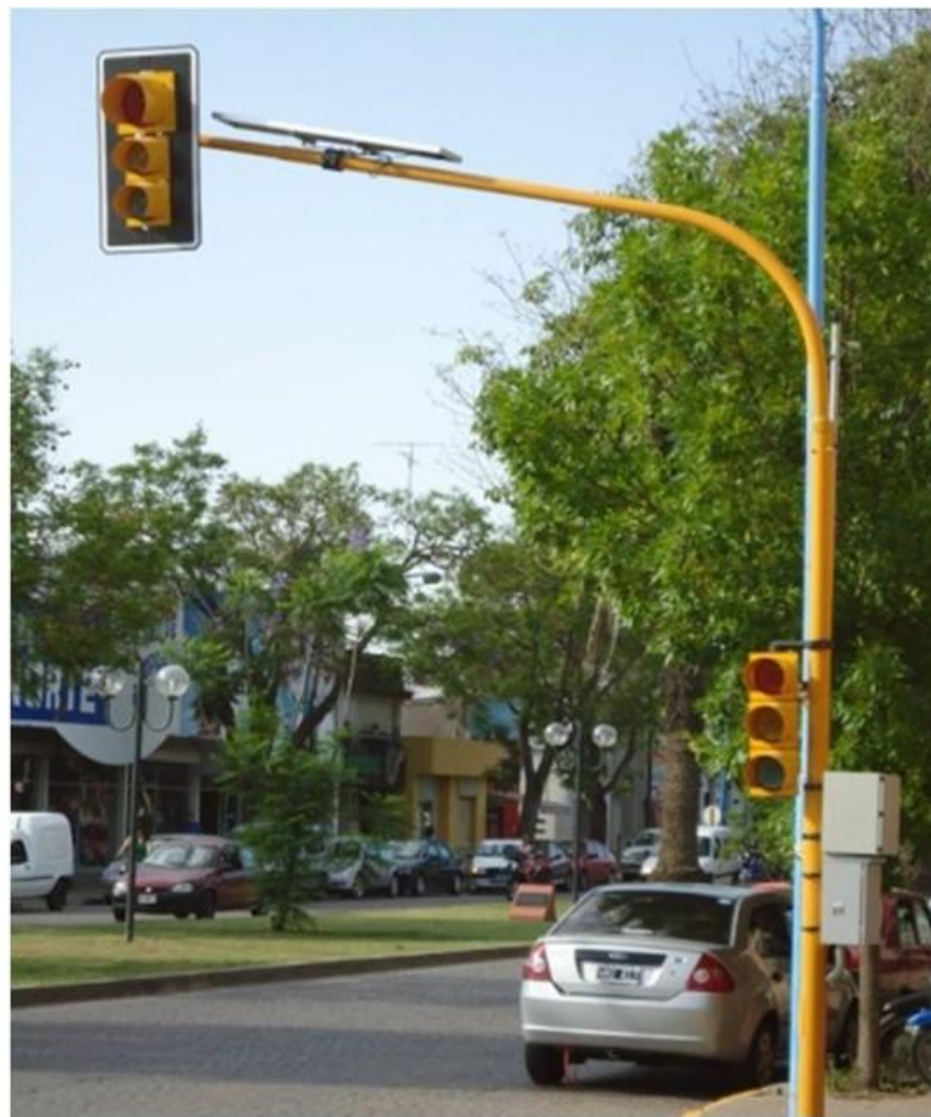
SEMÁFORO LED SOLAR
