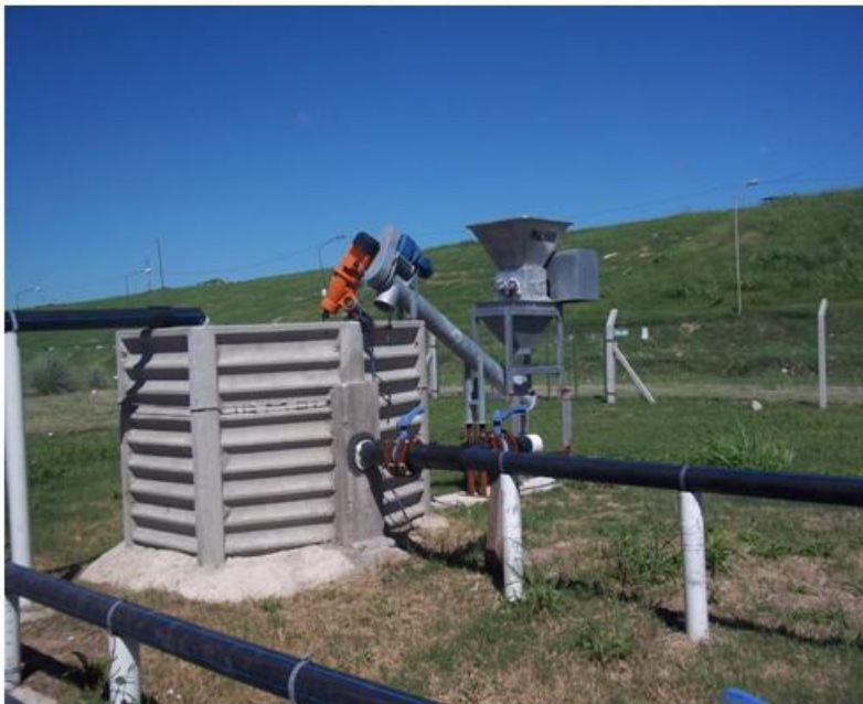
Tanque de Ingreso. Sistema de trituración y alimentación
