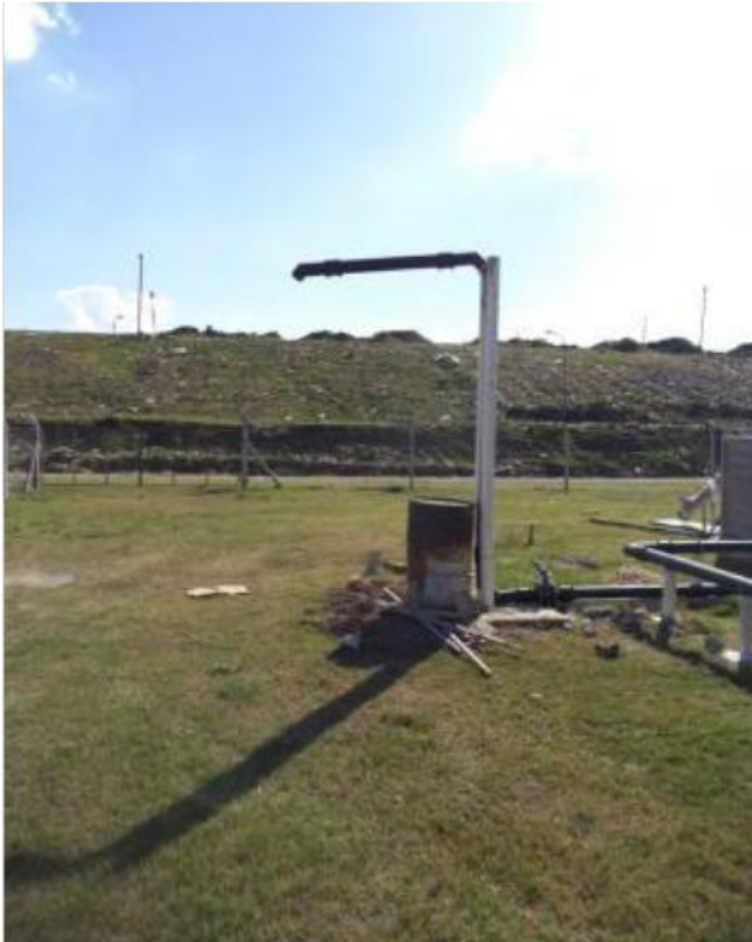
Sistema para carga de biol en camiones
