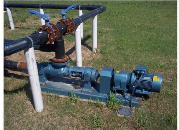
Bomba multipropósito y cañerías
