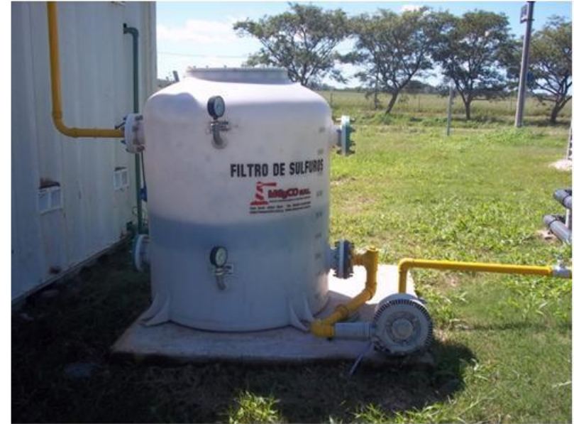
Tanque de descarga
