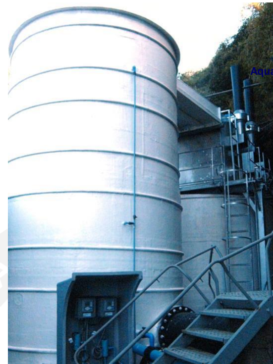
Torre de contacto 6.0 m
