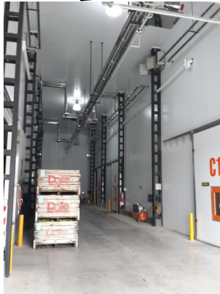
Cámara de almacenamiento
